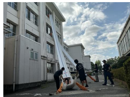
【3階と4階のそれぞれ2箇所に救助袋が設置されています。】
