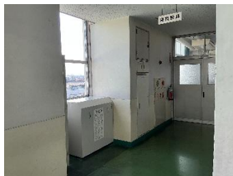
救助袋は3階と4階にそれぞれ2カ所設置してあります。
